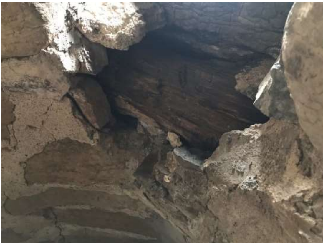
Fig. 2. En bit av den horisontella, grova bjälken i västra muren, som stolparna uppenbarligen står förankrade i, här sedd från spiraltrappan. Murverket är skadat under den översta ljusluggen i trappan. Till följd av det har bjälken här blivit rötskadad.
