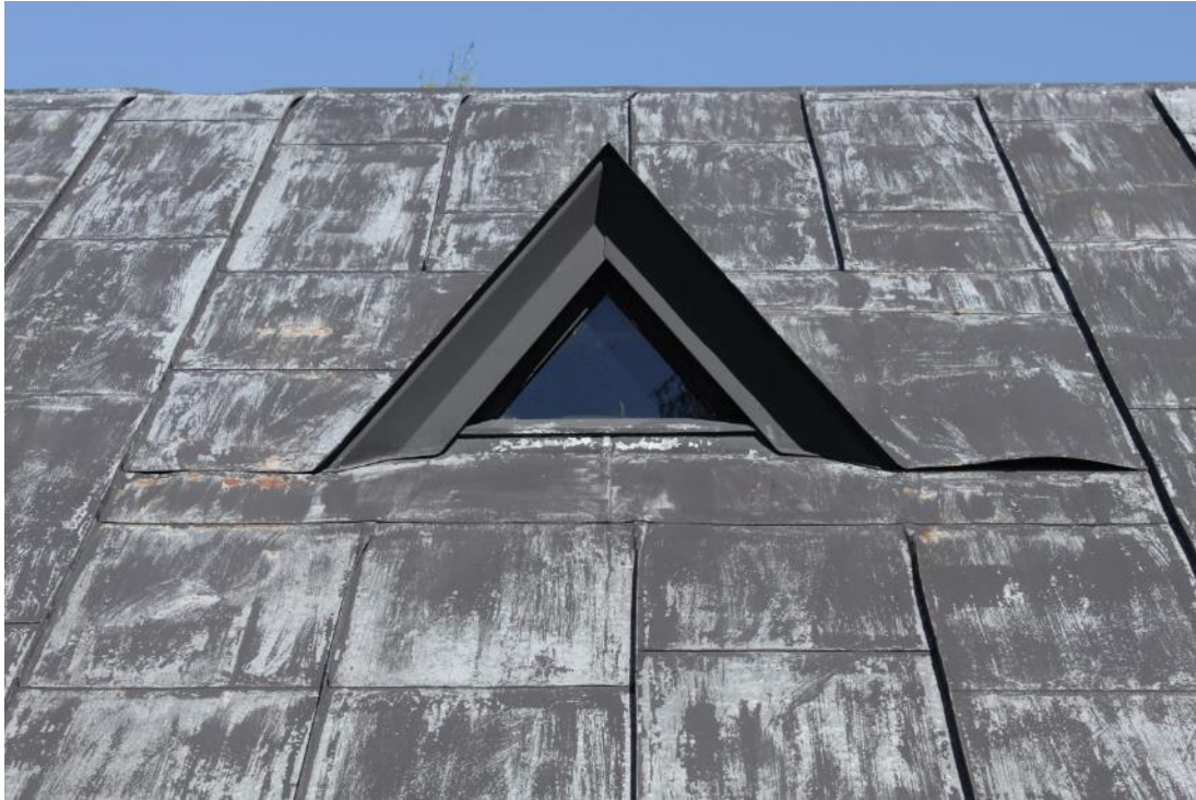
Figur 8. Intill takkupan på långhusets sydvästra takfall "bubblade" plåten upp.
