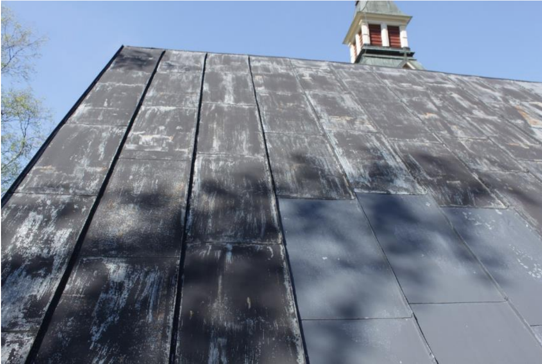
Figur 2. Takfall mot sydväst (västra korsarmen) före åtgärd 2020. Genom sin avvikande kulör framträder tydligt vilka plåtar som byttes ut på 1980-talet.
