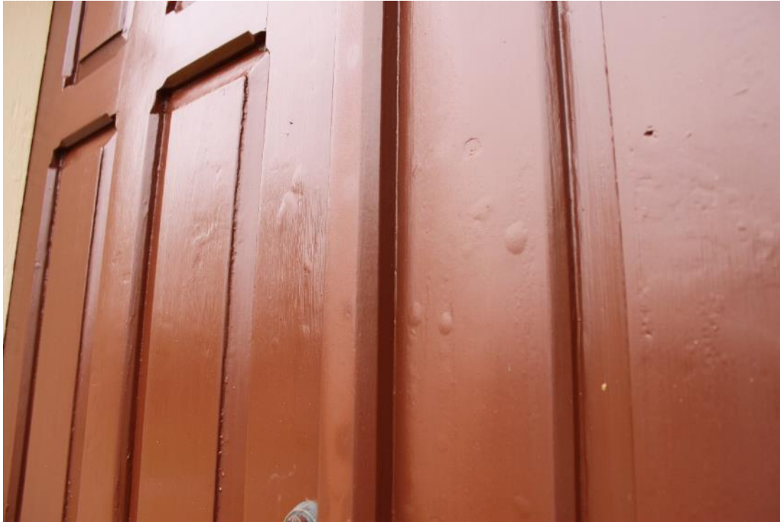
Figur 12 Entrédörren på tornet hade efter målningsbehandling 2019 fått blåsor.
