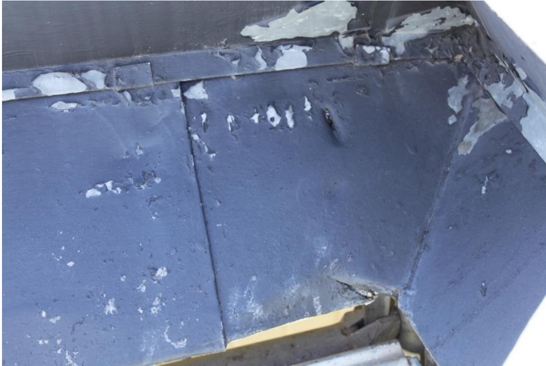
Figur 10. Ett mindre hål fanns före åtgärd närmast takfoten i mötet mellan östra korsarmens södra takfall och långhuset.
