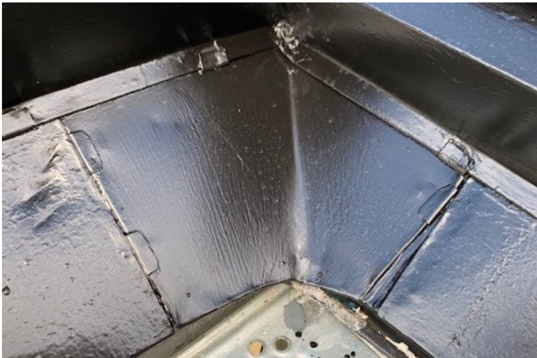
Figur 11. Vid skada närmast takfoten i mötet mellan östra korsarmens södra takfall och långhuset, har man öppnat fälsarna och dubblerat plåten ovanpå skadan. (Foto: Tobias Brandt)
