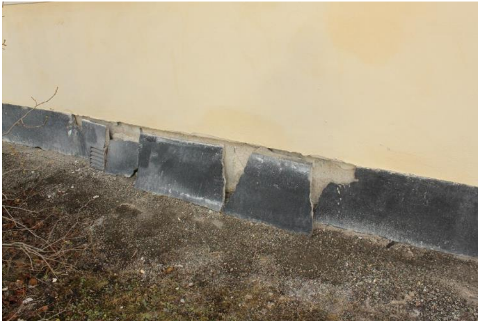
Figur 34 Lits kyrka 2018-11-05 Skada på sockel på södra sidan av långhuset.
