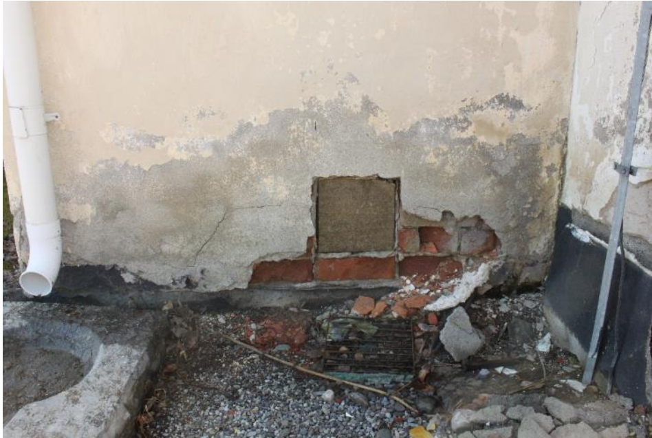
Figur 26 Lits kyrka 2018-05-07 Putsskada på transformatorbus.
