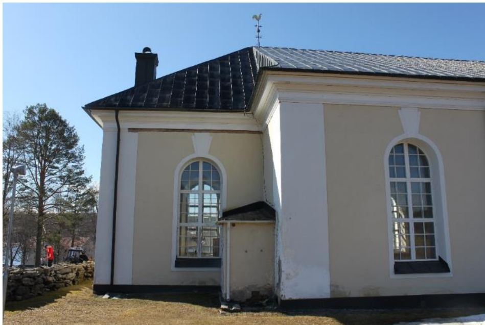
Figur 23 Lits kyrka 2018-05-07 Norra väggen på sakristian före åtgärd.
