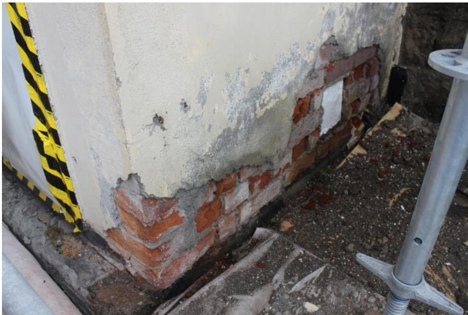
Figur 27 Lits kyrka 2018-08-29 Renknackad skada nedtill på transformatorbus.
