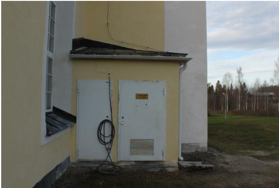
Figur 30 Lits kyrka 2018-11-05 Transformatorhus efter åtgärd.
