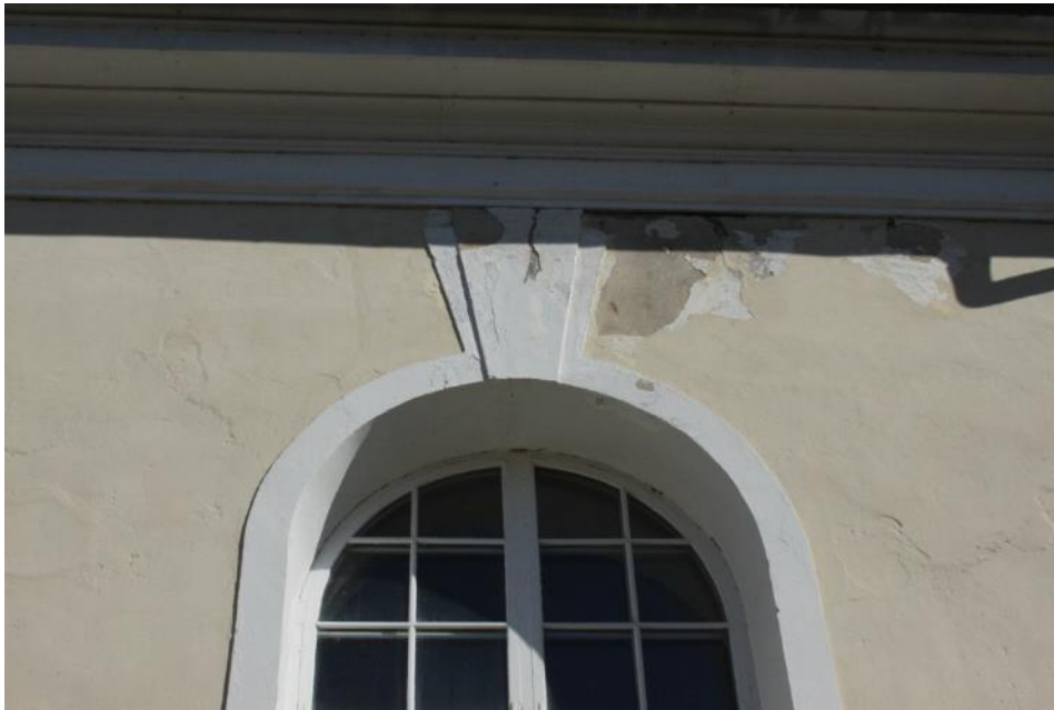
Figur 4 Lits kyrka, södra fasaden 2018-05-07 Puts och färgbortfall ovanför fönster.
