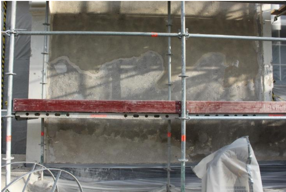
Figur 7 Lits kyrka södra fasaden 2018-09-13 Efter blästringen framträdde gamla lagningar tydligt på fasaden.
