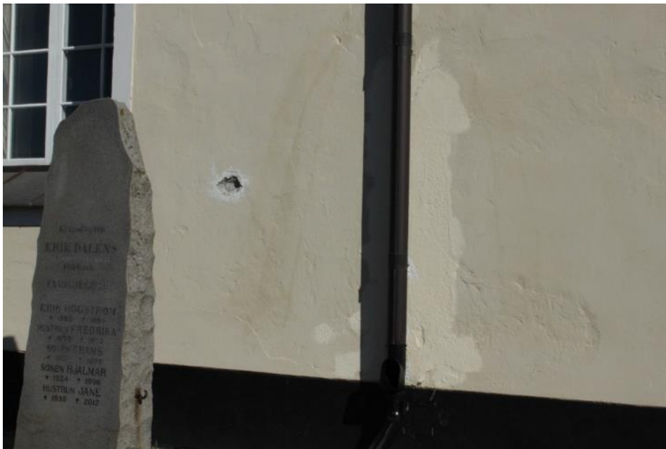
Figur 3 Lits kyrka, södra fasaden 2018-05-07 Putsbortfall, lagning och avfärgning med avvikande kulör i anslutning till stuprör.
