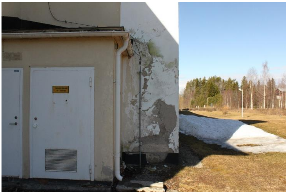
Figur 10 Lits kyrka 2018-05-07 Östra gaveln på långhuset före åtgärd.
