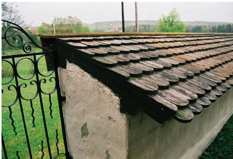
Den äldre spåntäckningen, här syns färgrester från tidigare målning
