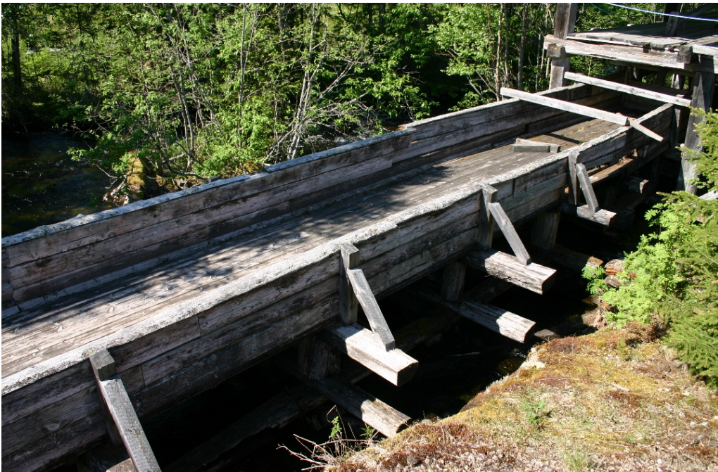
Intagsränna före åtgärder.
