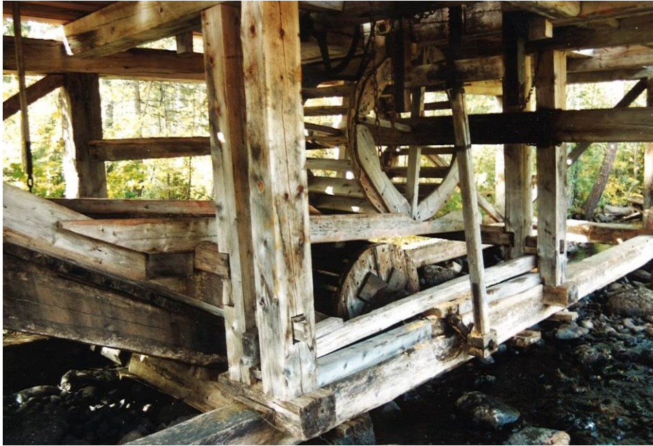
Stolparna på bärlinan (E) var rötskadade i nederkant. Bildnr: Jlm 2006m084.
