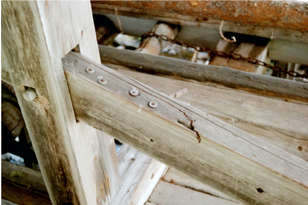
Hävstången till dammluckan hade knäckts vid infästningen i stolpen. Bildnr: Jlm 03m211/27
