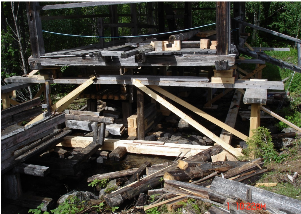
B-väggens nya syll på plats och ihoptimrad med A-, E- och C-syllarna. Foto Stig Nilsson.
