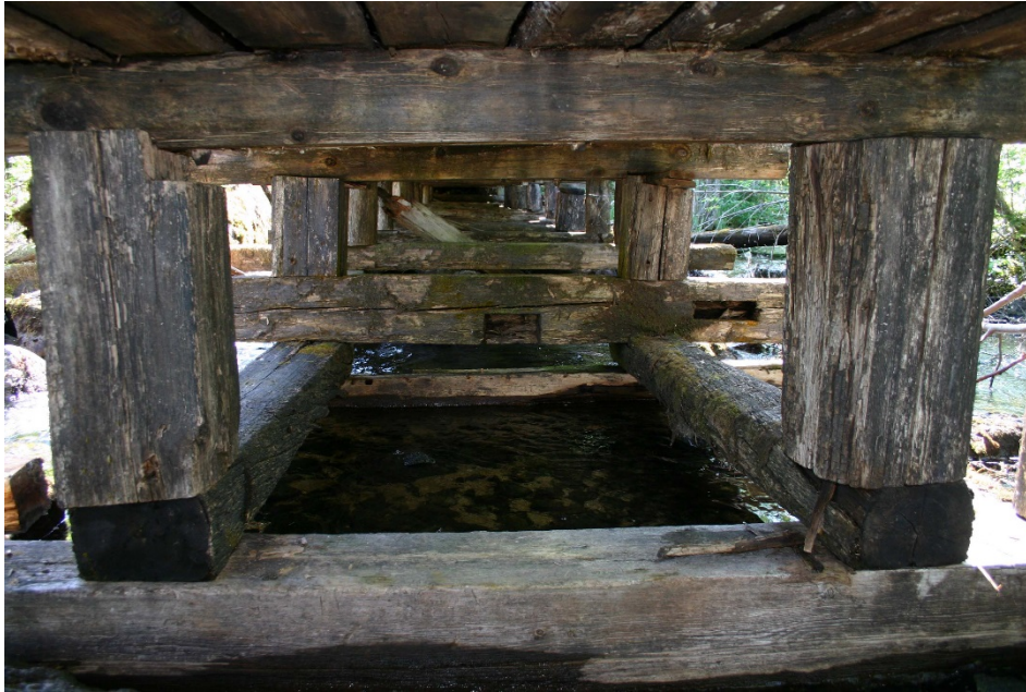
Intagsrännans bärande stolpkonstruktion, före åtgärder.
