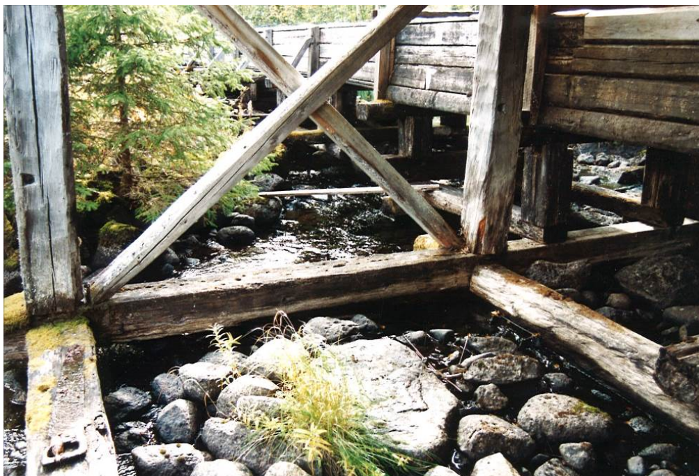
B-vägg, de två snedsträvorna var rötskadade i nederkant. Bildnr: Jlm 2006m084.
