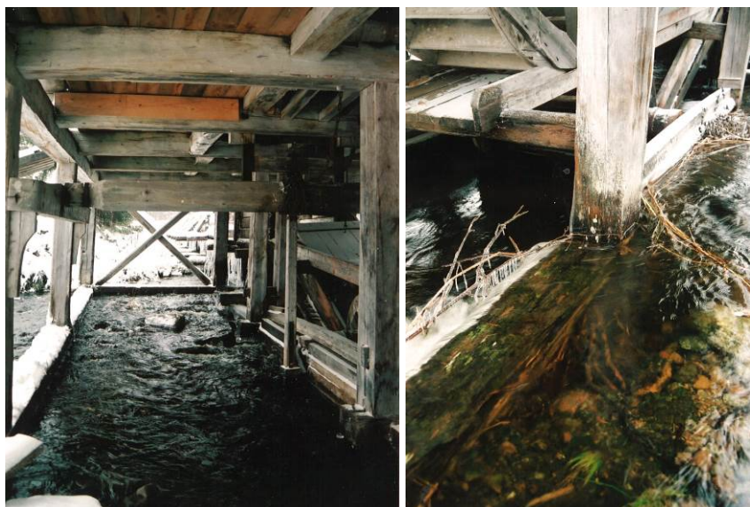
Grundstenarna hade sjunkit och syllarna hade därmed hamnat under vattenytan. Bild till vänster visar A-vägg och bärlina. Bild till höger visar C-väggens syll. Bildnr jlm-2008m084.
