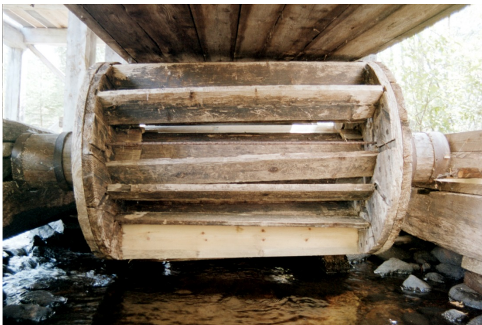
Det nedre vattenhjulet saknade flera av skovlarna. Jlm 03m211/09
