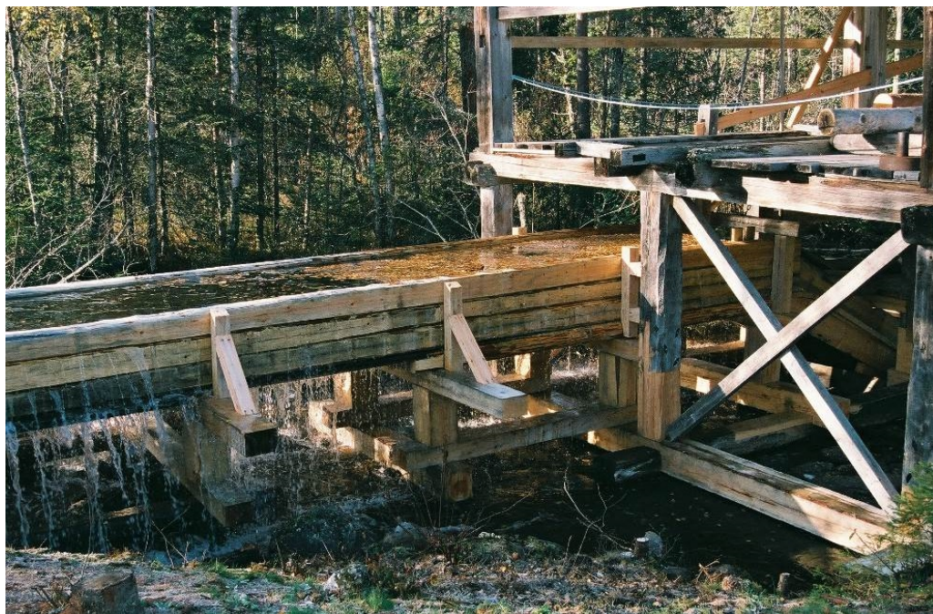
Rännans timmervägg har bytts ut ca 10-12 m till nytt bilat virke. Ett flertal stolpar och balkar tillhörande rännans fundament har också bytts ut.
