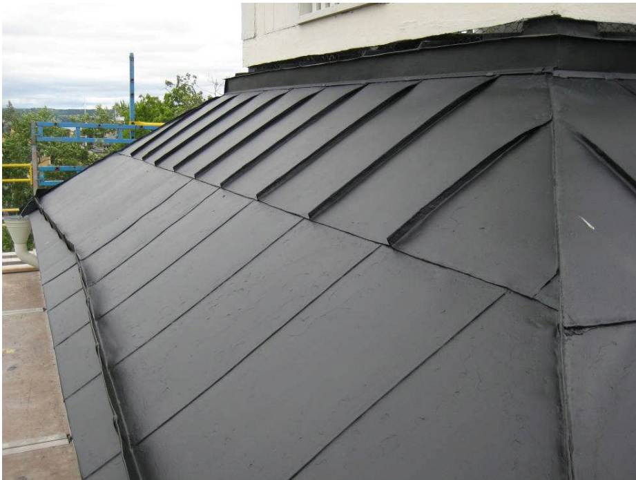
Tornets södra takfall efter målning (digital bild 1762).
