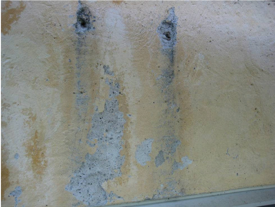
Skador efter stegen på den norra långhusväggen (digital bild 1636).
