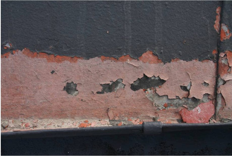
Under det svarta fanns två olika röda lager med rostskyddsfärg (digital bild 0433).
