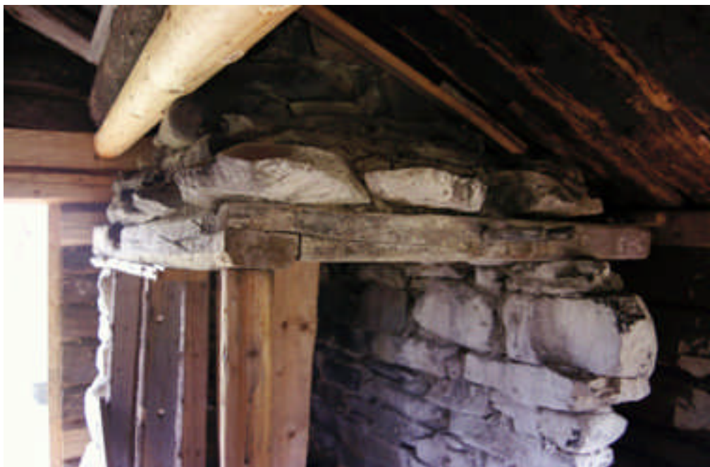
Bild 2: Murkransen innan restaurering
