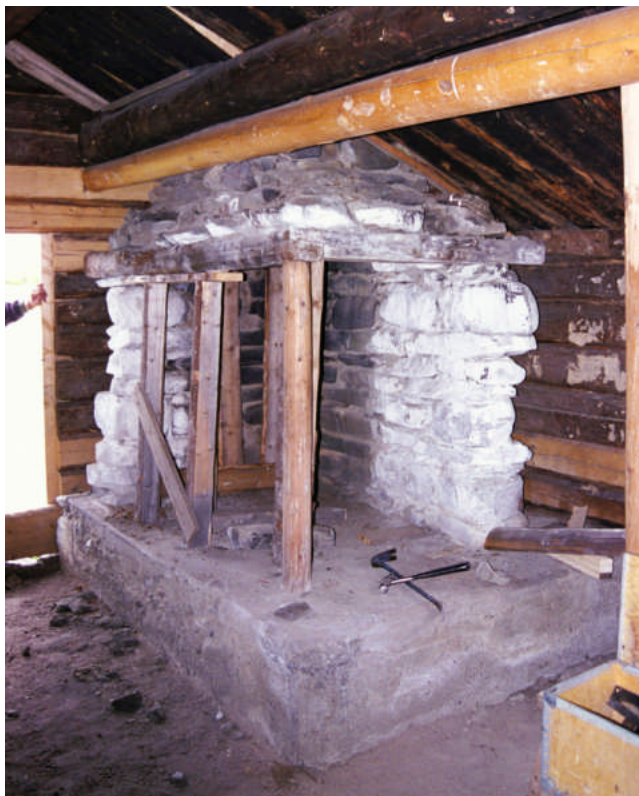
Bild 1: Murkransen innan restaurering.
